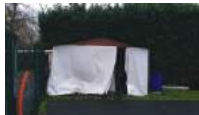
1. Le bâtiment est un abri en bois de type abri de jardin, utilisé pour le stockage du club.
